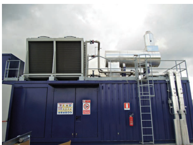
Il container insonorizzato che contiene il cogeneratore e il sistema di raffreddamento del motore
